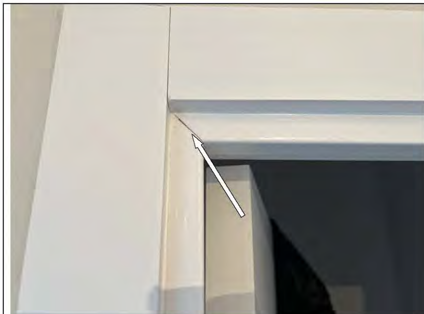
Фото №58. Элементы дверного блока в гардеробной соединены не надежно (коробка).
