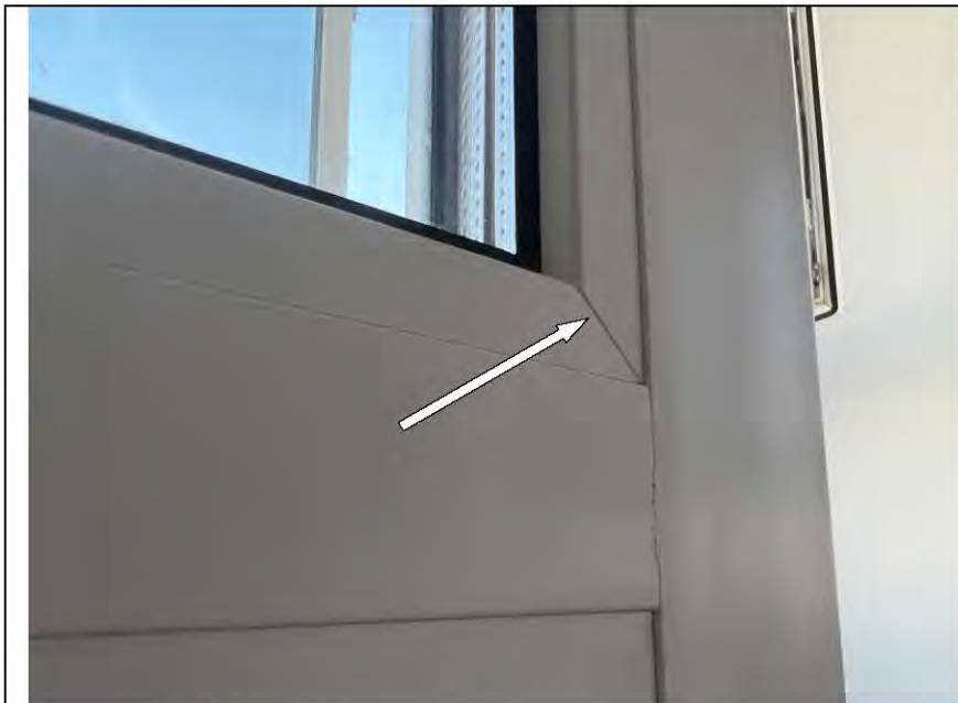
Фото №46. Зазоры в стыках профиля ПВХ оконного блока в кухне.
