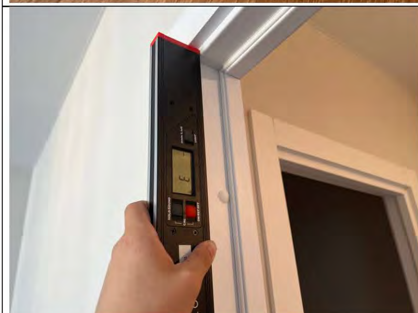
Фото №62. Отклонение коробки дверного блока в спальне на 3 мм.
