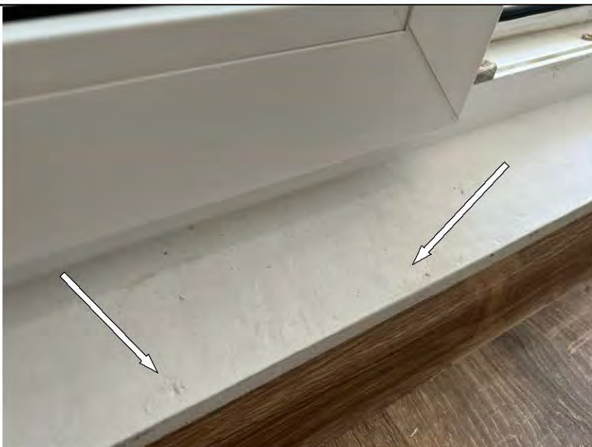
Фото №35. Механические повреждения и подтеки краски на откосах оконного блока в кухне.
