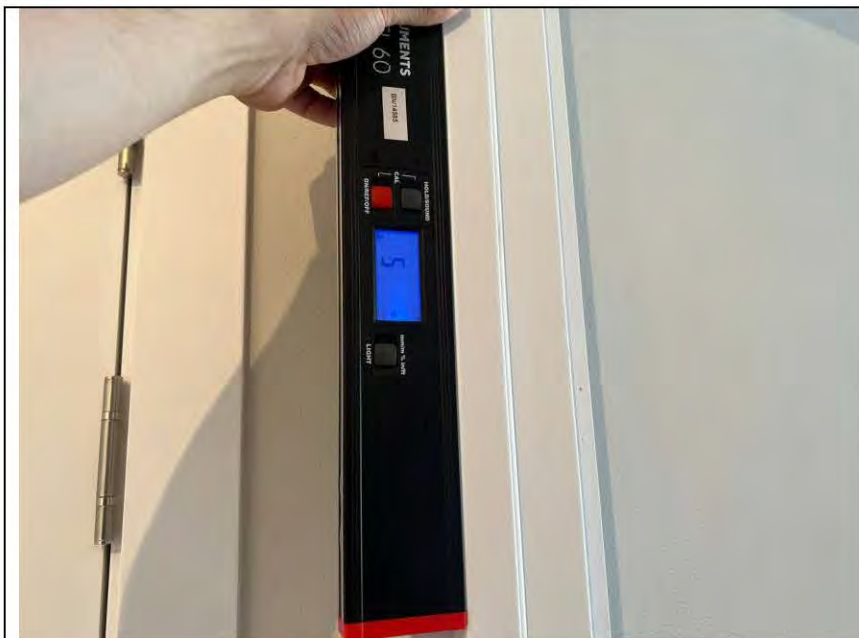
Фото №64. Отклонение коробки дверного блока в кухне на 5 мм.
