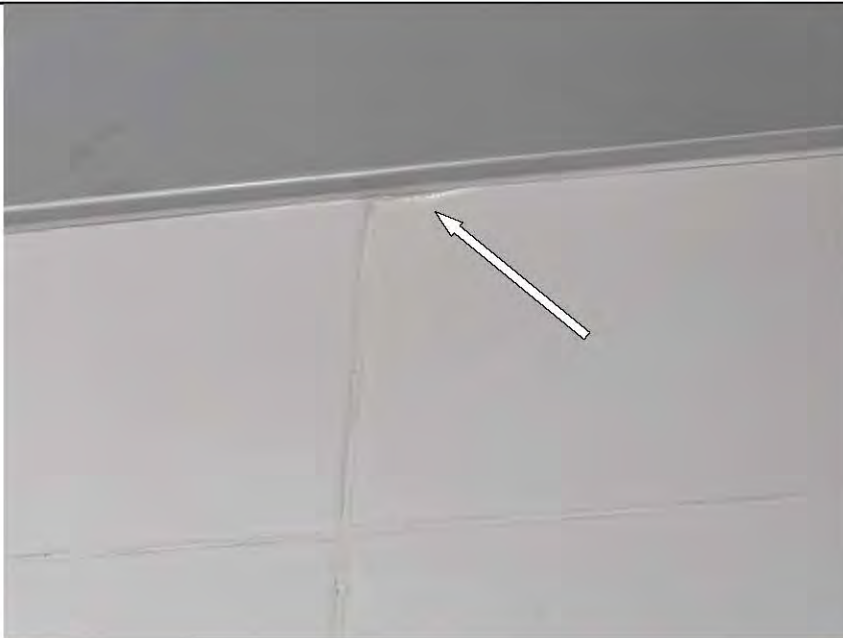
Фото №26. Скол настенной керамической плитки в ванной комнате.
