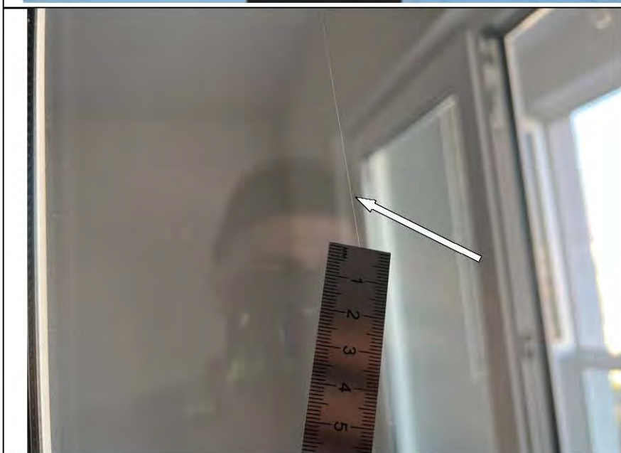
Фото №41. Царапина на стеклопакете оконного блока ПВХ в кухне.
