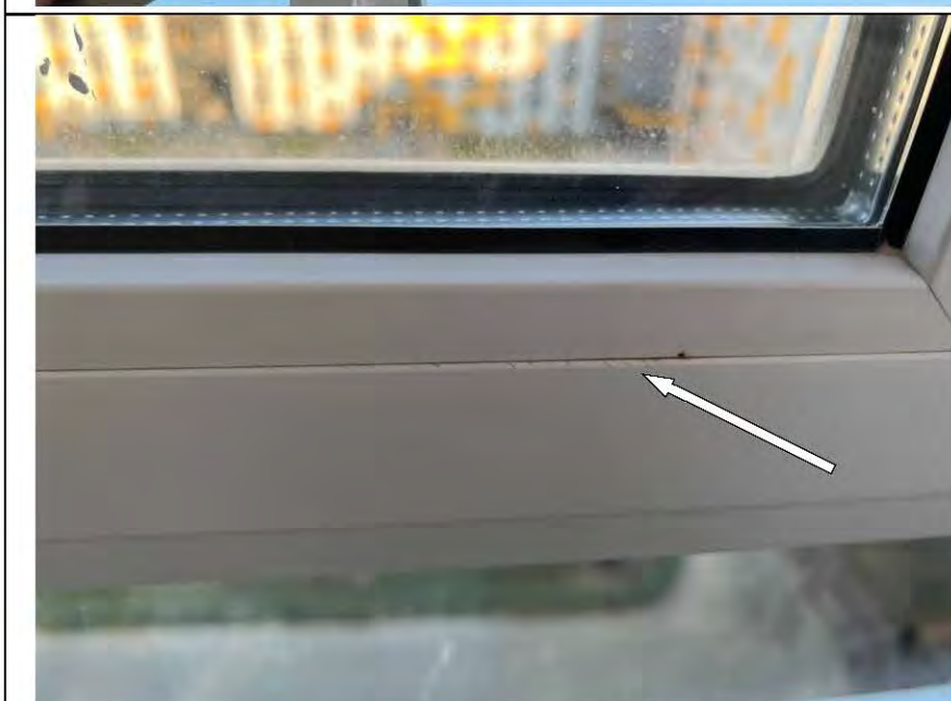
Фото №44. Механические повреждения профиля ПВХ оконного блока в лоджии.
