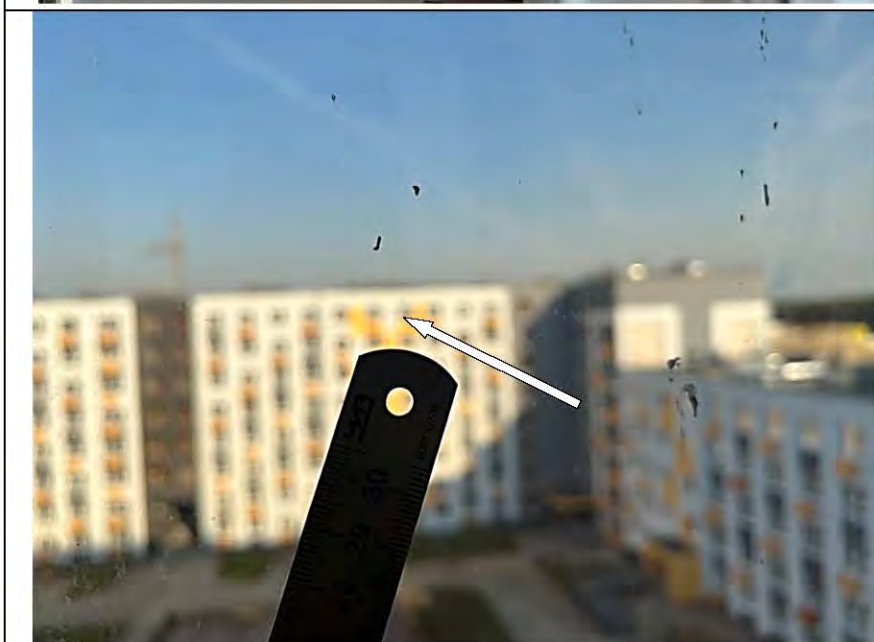
Фото №42. Царапина на стеклопакете оконного блока ПВХ в лоджии.
