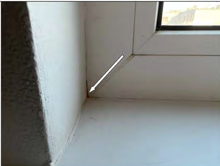
Фото №34. Щель в стыке откосов и оконной рамы в спальне.
