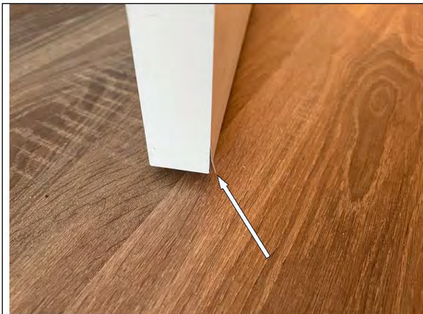
Фото №61. Отслоение ламинации на лицевой поверхности полотна дверного блока в кухне.
