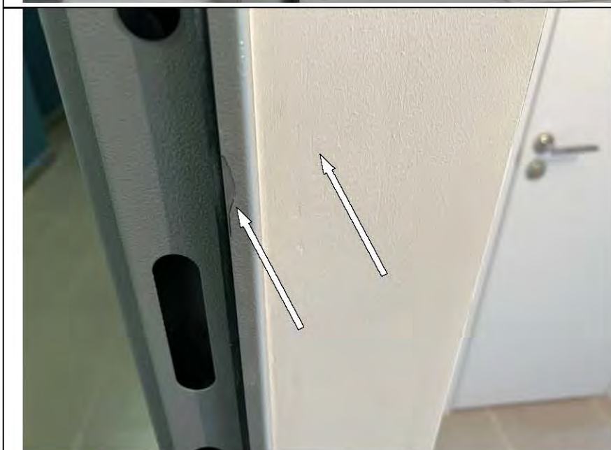
Фото №38. Механические повреждения короба и подтеки краски на откосе входного дверного блока.
