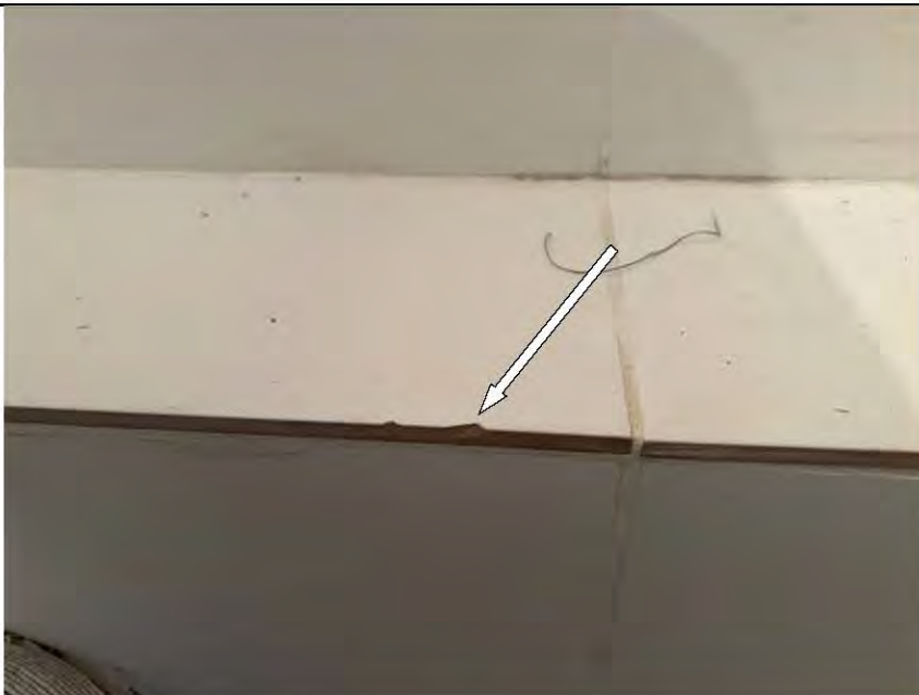
Фото №27. Скол настенной керамической плитки в ванной комнате.
