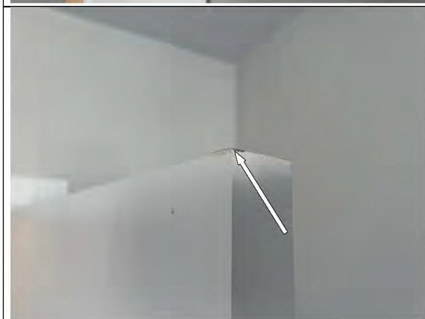
Фото №60. Отслоение ламинации на лицевой поверхности полотна дверного блока в спальне.
