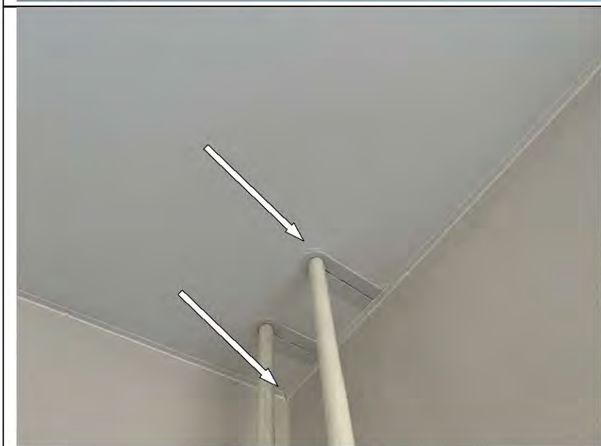
Фото №48. Соединение декоративного молдинга натяжного потолка в спальне выполнено некорректно. Замятие полотна натяжного потолка в спальне.
