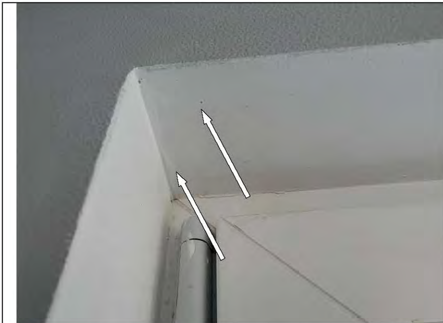
Фото №37. Механические повреждения и подтеки краски на откосах оконного блока в лоджии.
