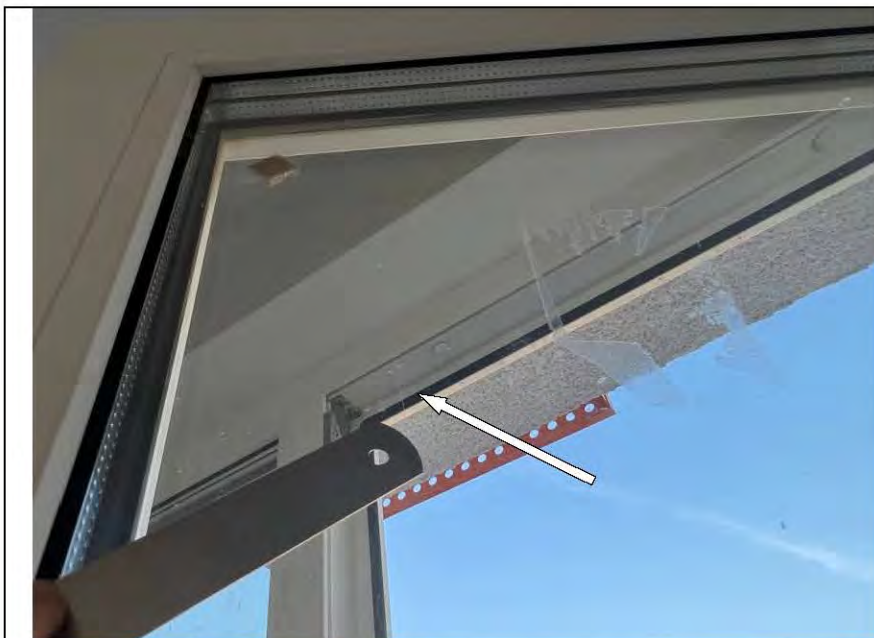
Фото №43. Царапина на стеклопакете оконного блока ПВХ в лоджии.
