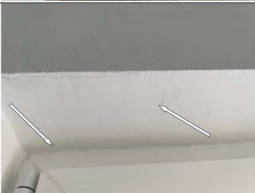
Фото №36. Механические повреждения и подтеки краски на откосах оконного блока в спальне
