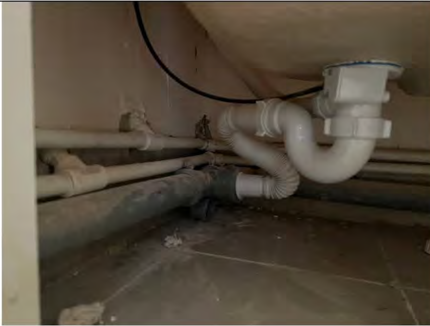
Фото №25. Отсутствует настенная керамическая плитка за ванной.
