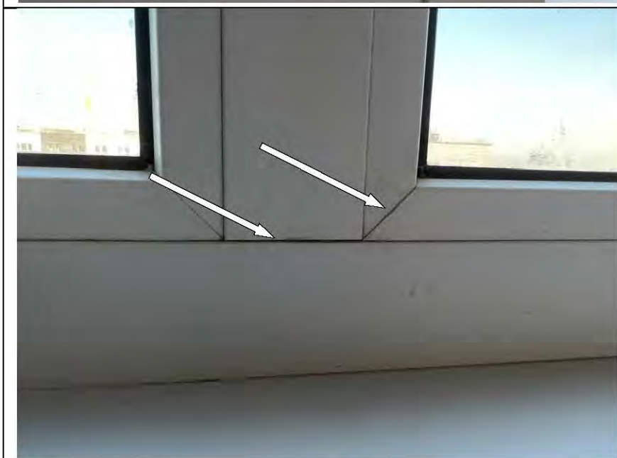
Фото №47. Зазоры в стыках профиля ПВХ оконного блока в спальне.
