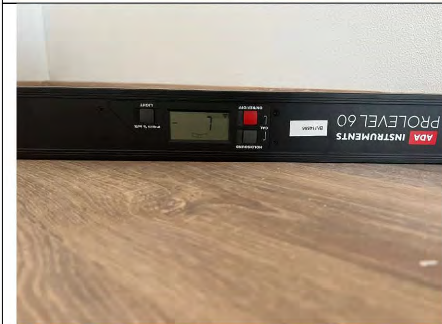
Фото №30. Измерение уровня напольного покрытия в кухне.
