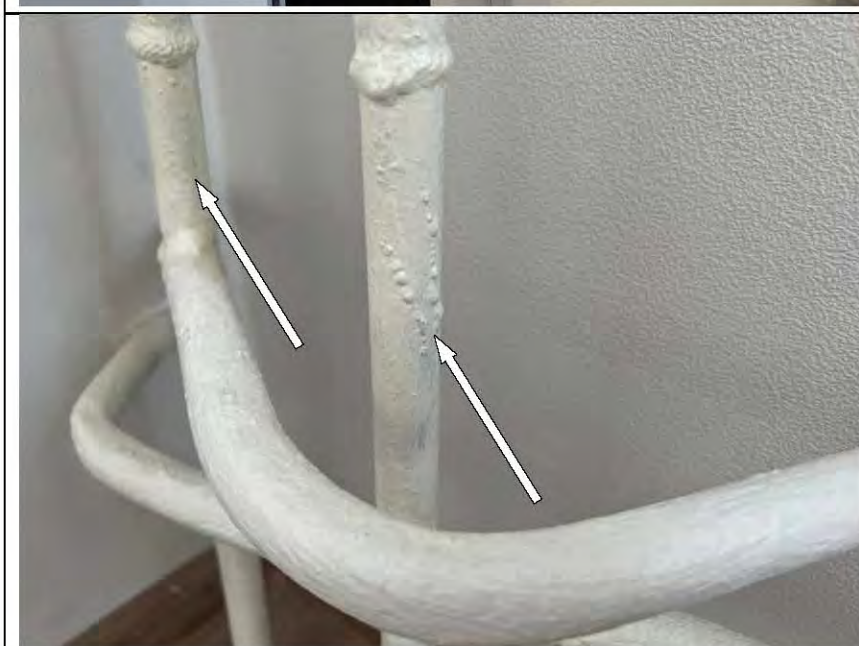
Фото №66. Подтеки краски на трубах отопления в спальне.
